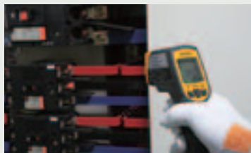
Apparecchiature in tensione
