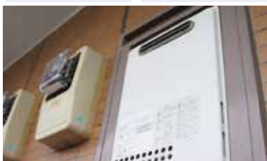
Controllo della "corrente di fiamma" del bruciatore (DT4253)
