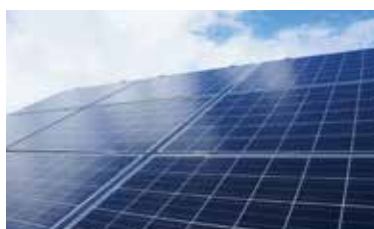
Applicazioni in ambito fotovoltaico
